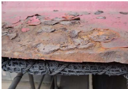
(a) 主桁の下フランジ上面の例
