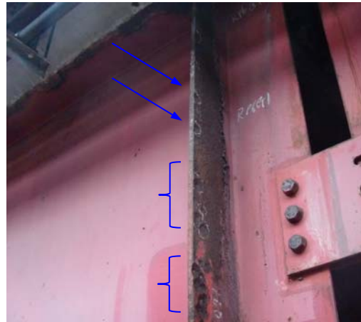
(b) 支点上補剛材の例（孔食を伴うもの）
