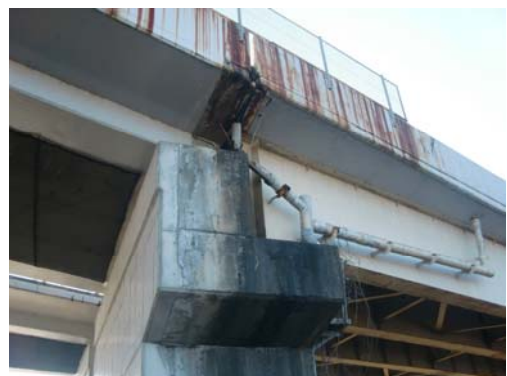
図-解 2.1.2 伸縮装置からの漏水
