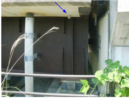
図-解 2.1.3 不適切な橋面排水
