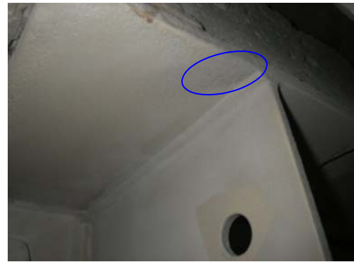
(a) 損傷位置
