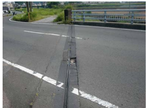
図-解 2.1.1 伸縮装置の破損
