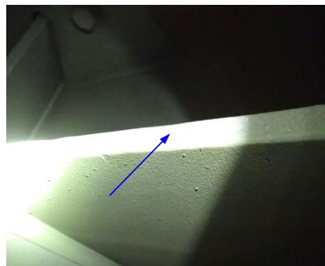
図-解 3.2.9 コバ部における封孔処理の施工漏れの事例
