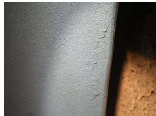
図-解 3.2.7(a) 前施工部の皮膜剥離位置に溶射を重ねた不具合事例(その1)
