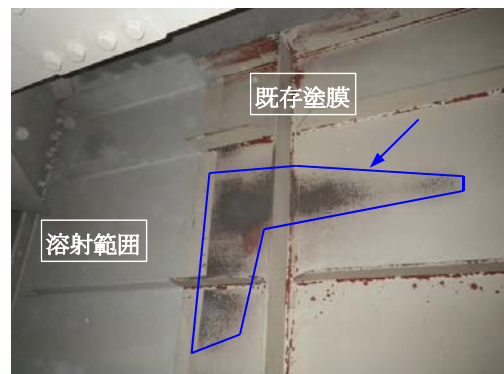
図-解 3.2.4 溶射範囲外の既存塗膜を損傷させた不具合事例
